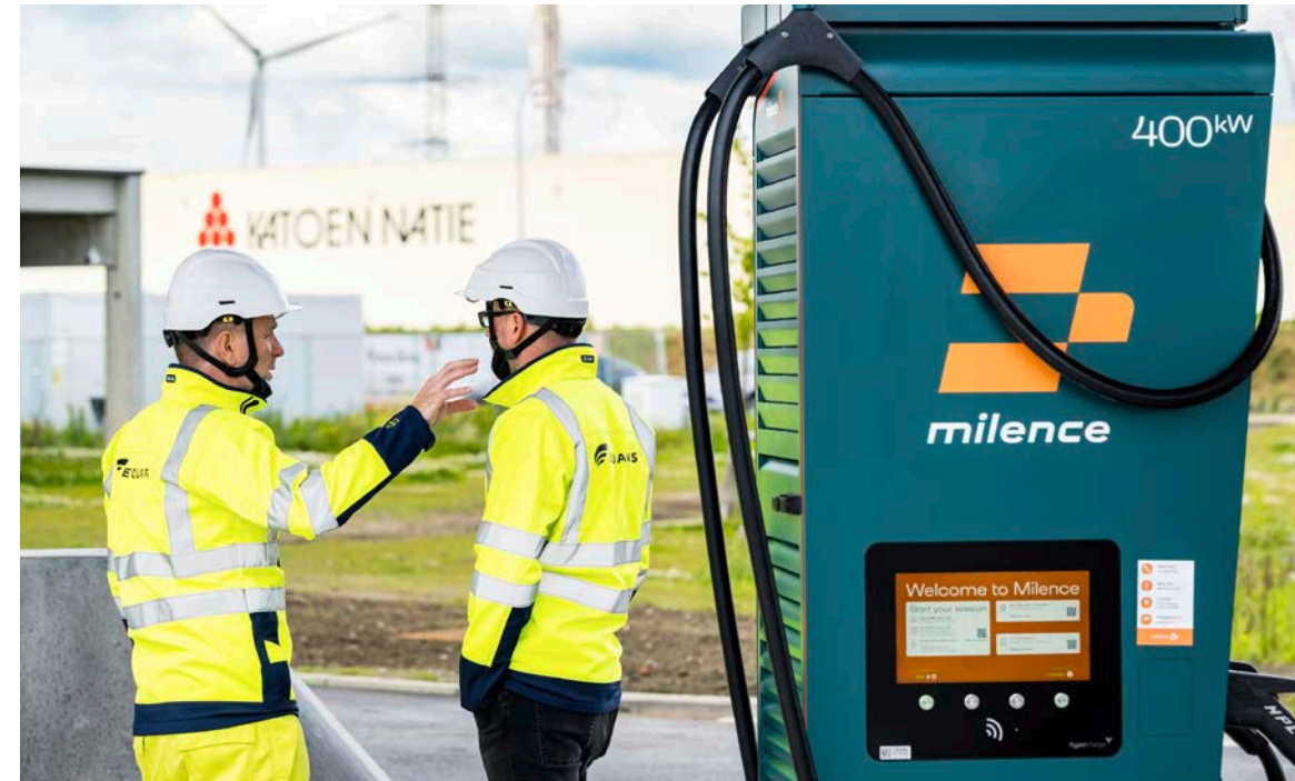
© Près du port d'Anvers (Belgique), nous avons équipé une station de recharge électrique permettant d'alimenter 20 camions simultanément.
